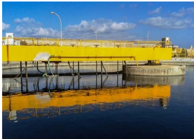
Εικόνα 13 (Δευτεροβάθμια Δεξαμενή Καθίζησης Κέντρου Επεξεργασίας Λυμάτων ΚΕΛ Νομού Χανίων)
