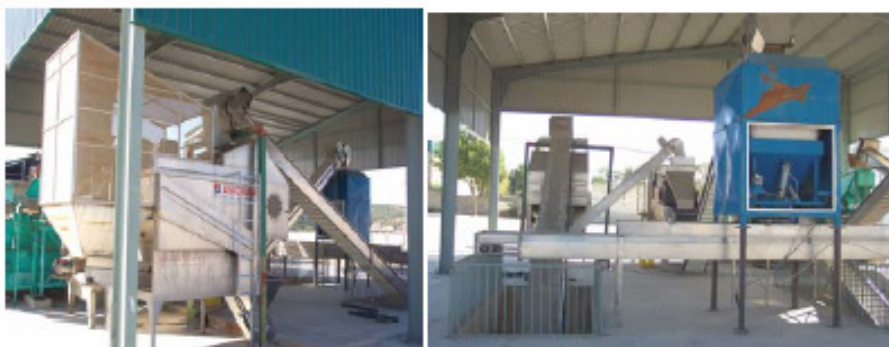
Σχήμα 1.1 : Εγκατάσταση καθαρισμού και πλύσης των καρπών της ελιάς
